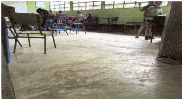
Foto1: piso rústico de aula No.1 del Módulo 1. Se instalará piso cerámico.
